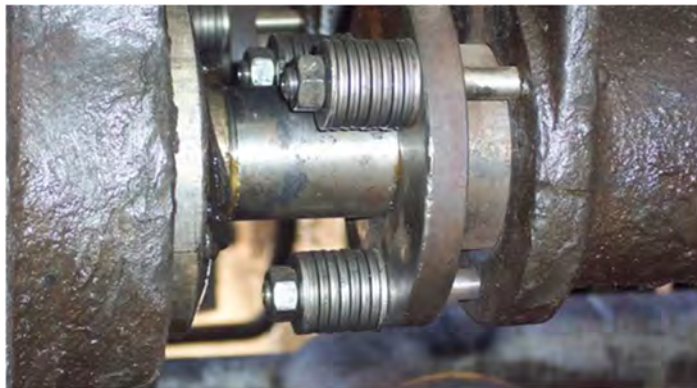
Abbildung 59: Tellerbefederung an einem Kühlaggregat
